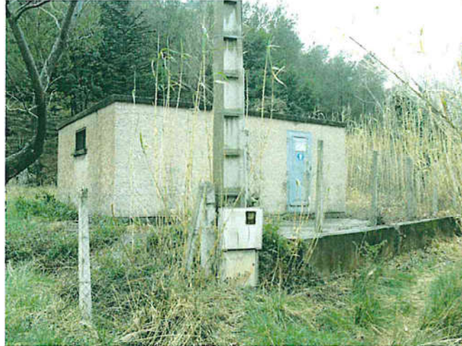
Captage de la source de Roquefourcade
