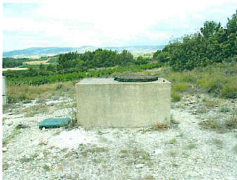
Captage du forage de La Croisade
